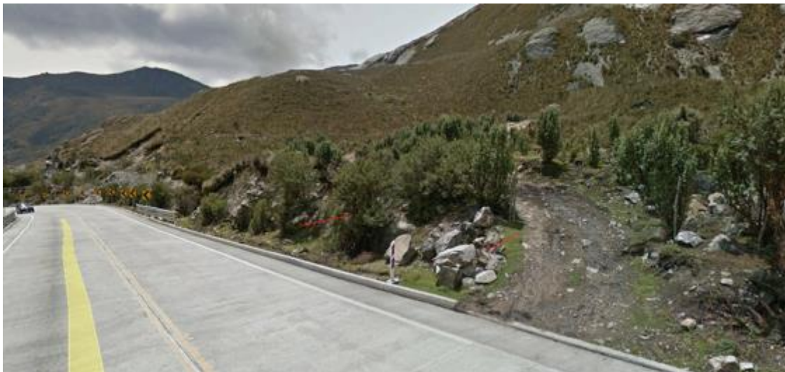
Fotografía 7- 4: Estado de la vía de acceso por la Cuenca-Molleturo, Sector Biscochos
